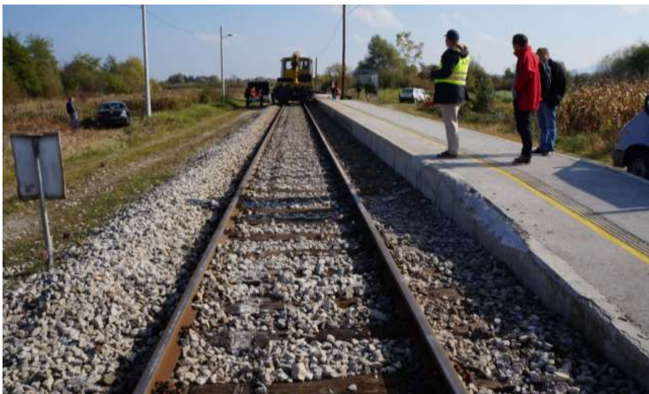
Slika 5. – Oštećenja na peronu stajališta Kuljevčica (izvor slike: AIN)
